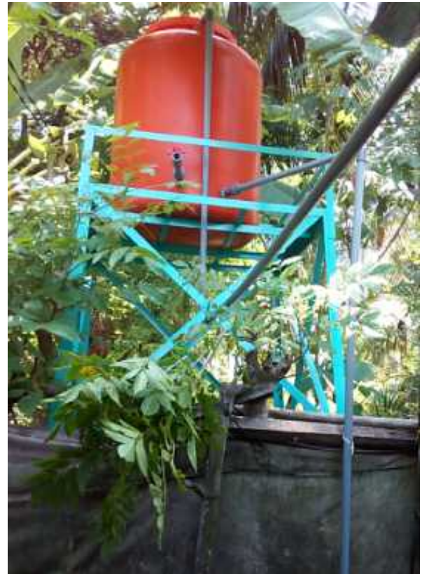
Gambar 9. Instalasi pipa yang menuju ke tangki penyimpanan.
