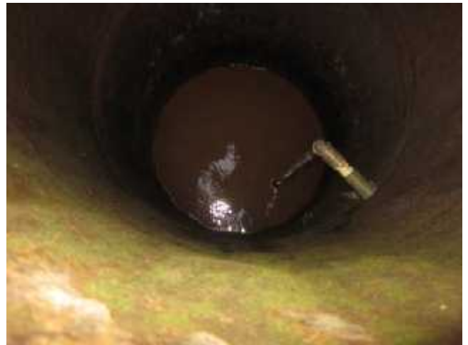
Gambar 12. Kondisi air dalam sumur yang sangat keruh.
